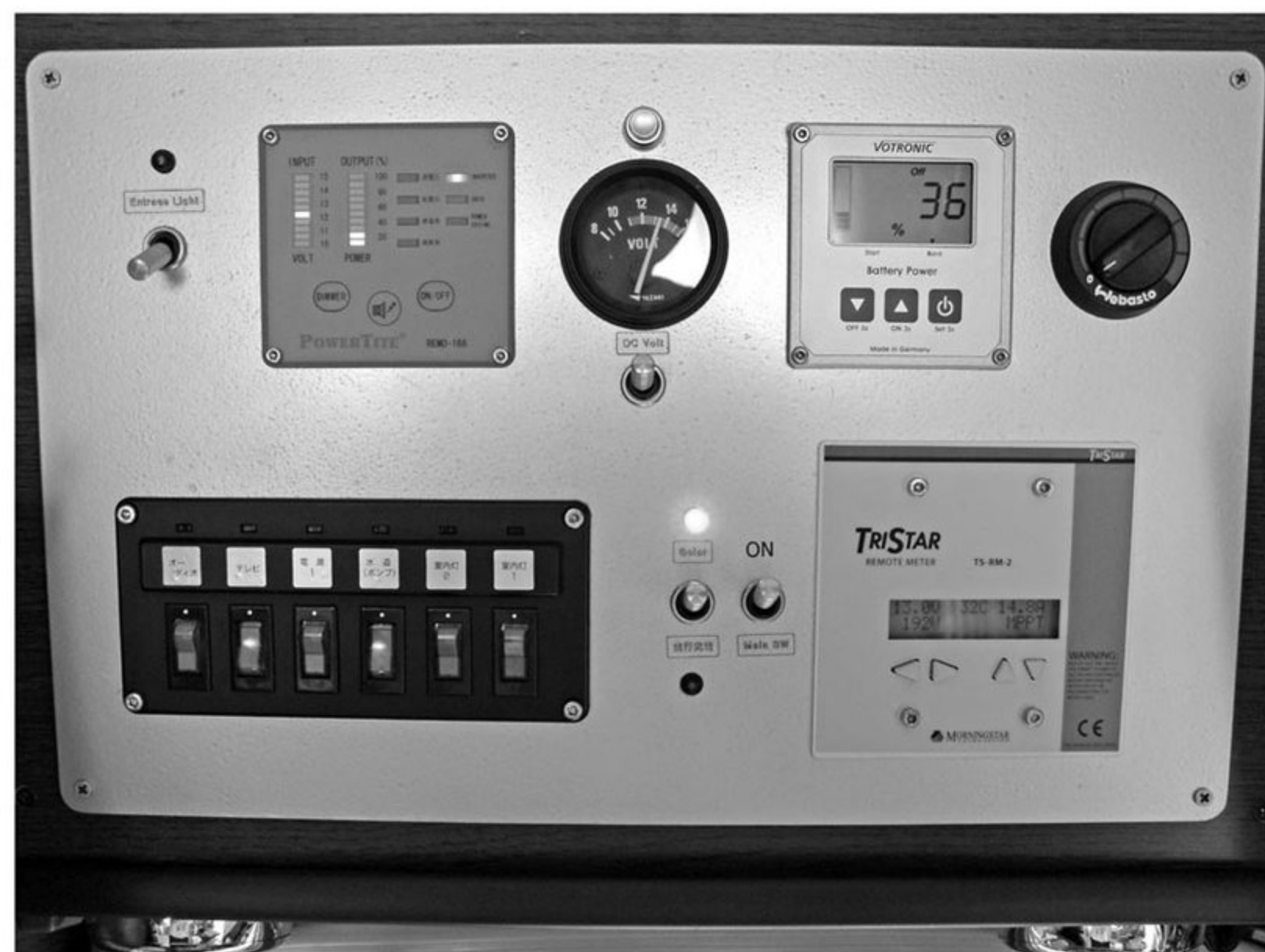
●自作したコントロールパネルです。上段右からFFヒータースイッチ、残量計、Vメーター、インバータースイッチ、デッキ照明スイッチ、下段右から、ソーラー発電計、ソーラー走行スイッチ、各種スイッチとなっています
