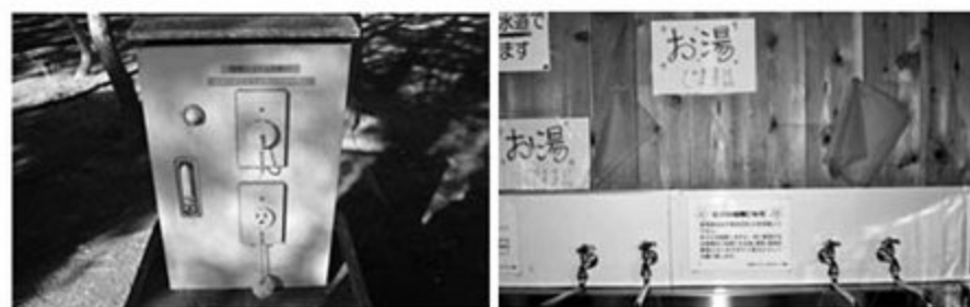
●電源は15A。コンセント口は2つ利用できる。お湯が出る快適な炊事場。壁面には生ゴミ用ネットがたくさん掛けてあり、各自で清潔に使えるようになっている。炉もあり！
