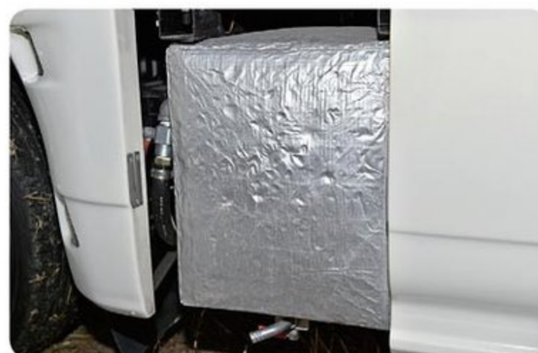
●シャワーやシンクで温水が使えるように小型ボイラーを備えている。ボイラーの性能を高めるために断熱カバーを設置
