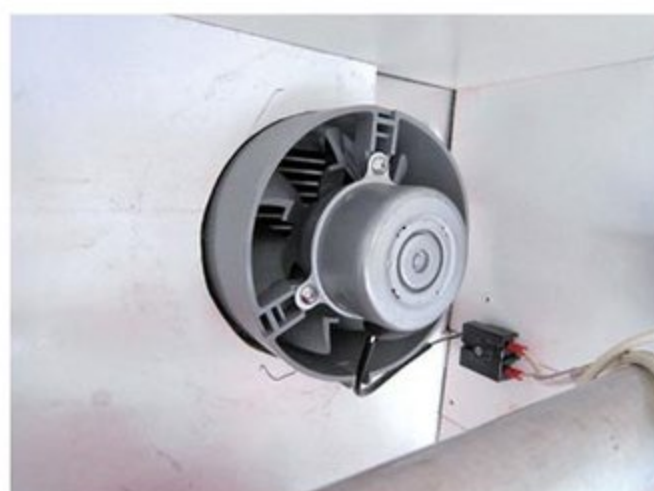
●換気には小型の換気扇を使用
