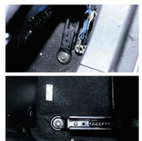
逆向きに取り付けたものが上の写真だ。溶接してきちんと固定することで、サーキットでのハードな走行でも問題なく使用できる。
