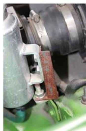
タンクのスターがさびびびび。見るからにみすばらしいので、こも新しくすることに。
