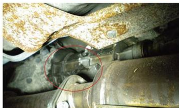
走行していないにもかかわらず、ミッションからは何やらオイルがにじみ出ている。こんなところにも影響が出ていたのだ。
